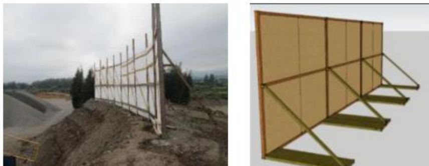
Imagen N°5. Barreras acústicas modulares.
