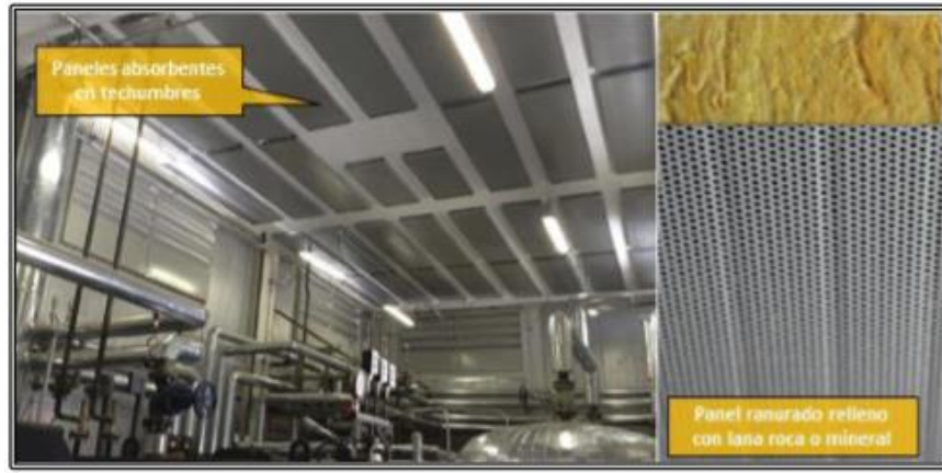
Figura 13. Ejemplo interior de galpón insonorizado con materiales absorbentes.
