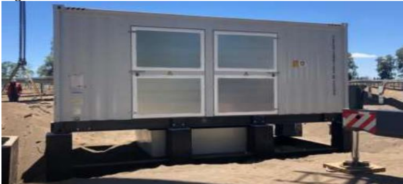
Fuente: Figura AC- 59: Fotografía de referencia instalación de transformador, Adenda Complementaria.
