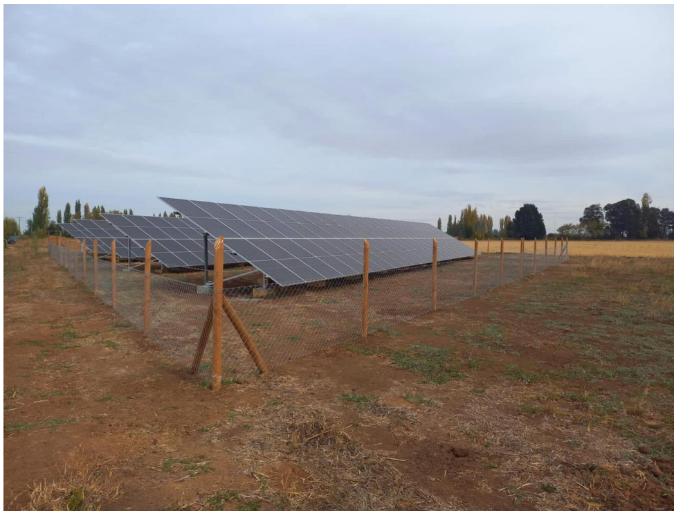
Fotografía 3: Paneles Fotovoltaicos Predio Santa Elisa. Coordenadas Este 245790,65 Norte 5999190,42
