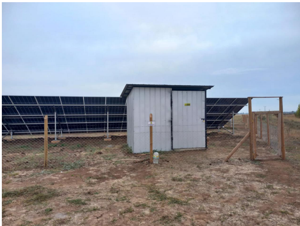
Fotografía 2: Paneles Fotovoltaicos Predio Santa Elisa. Coordenadas Este 245790,65 Norte 5999190,42
