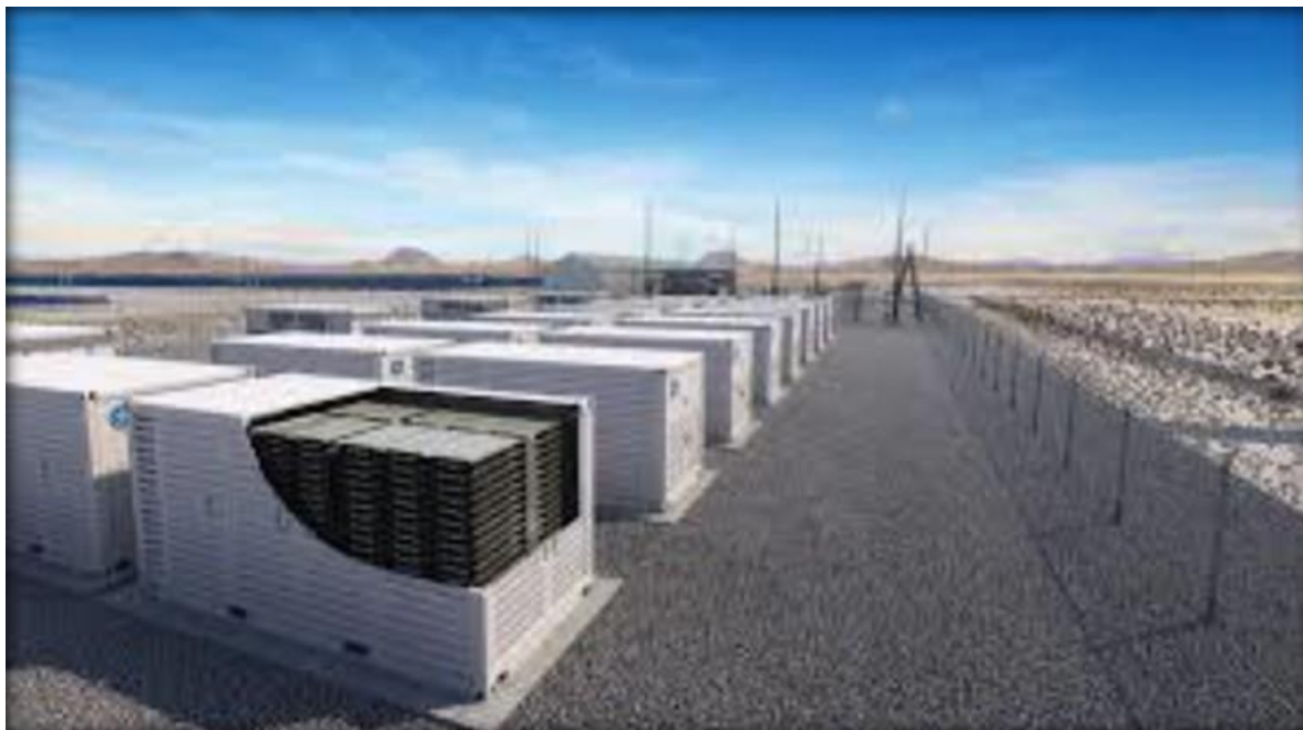
Figura N° 4. Vista típica de baterías en contenedores con visión interior de su contenido.
