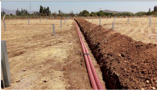
Fuente: Ilustración 22 de la Adenda “Detalle de ubicación del cableado al interior de zanjas”.
