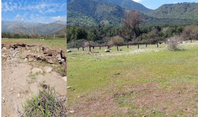
Figura 2. Erosión y desprendimiento de material en el sitio GH02 y estructuras construidas en el sitio GH01.
