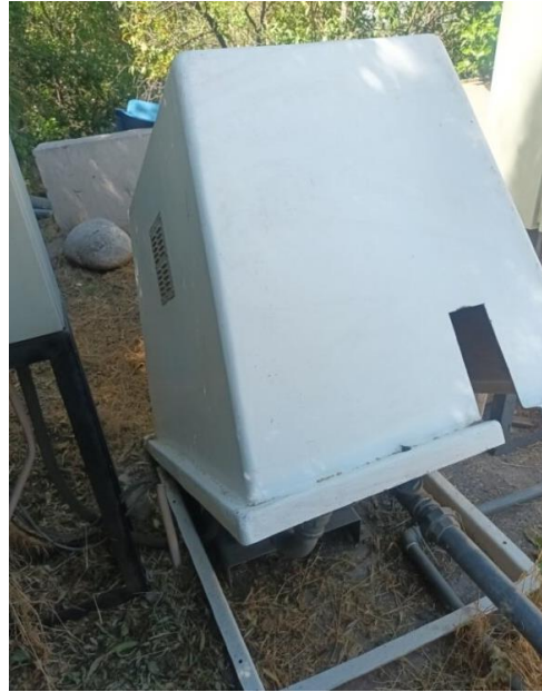
Figura N° 1 – Sopladores operativos planta de tratamiento caudal 22 m 3 /día
