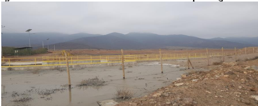
Figura 4: Vistas de Derrame al Píe del Muro del Depósito (junio 2022).
