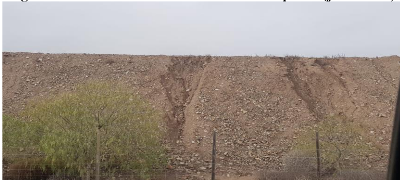
Figura 5: Vistas de Grietas en el Muro del Depósito (junio 2022).
