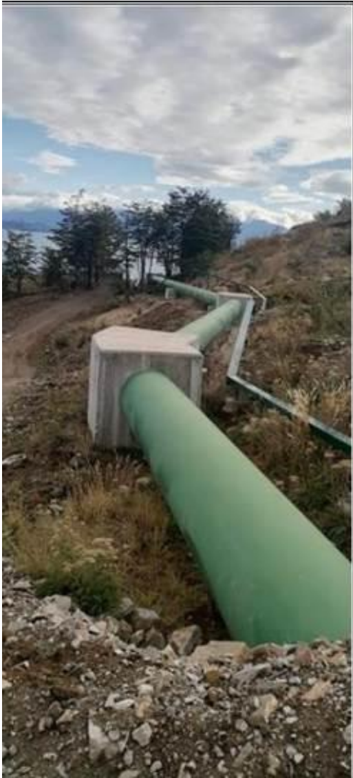
Figura 4.2.9.: Fotografías tubería de baja presión.
