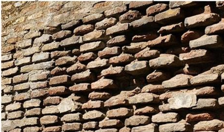
Figura 5. Vista de albañilería en muy mal estado.
