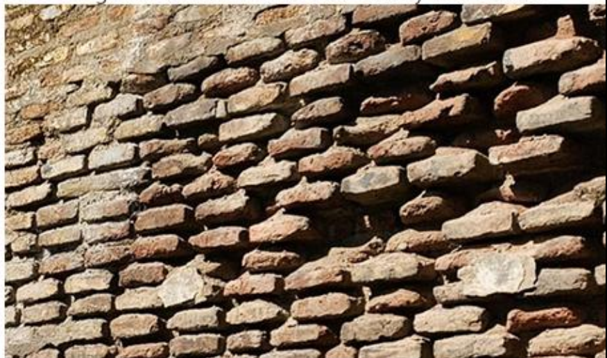
Figura 5. Vista de albañilería en muy mal estado.
