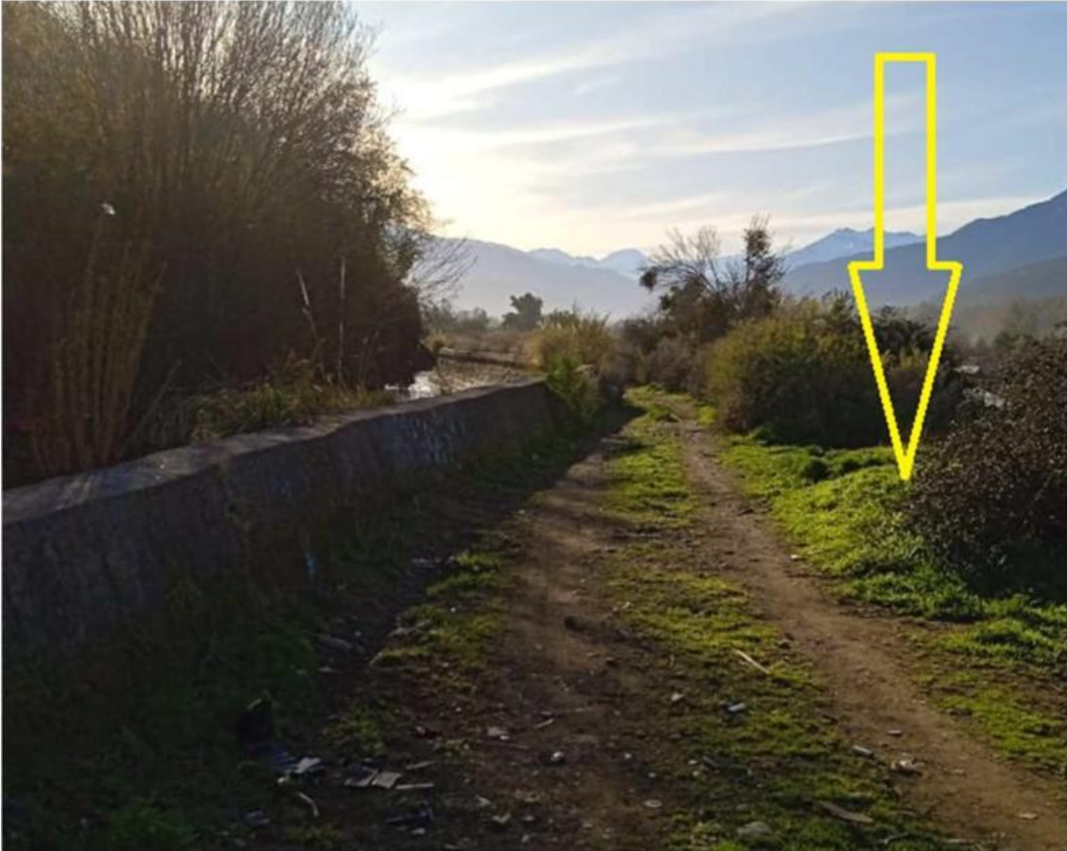
Fuente: Fotografía 1 Ejemplo sector donde se instalaría poste de hormigón a no menos de 5,0 m de distancia del borde del canal. – Anexo Adenda Ciudadana – Adenda Complementaria
