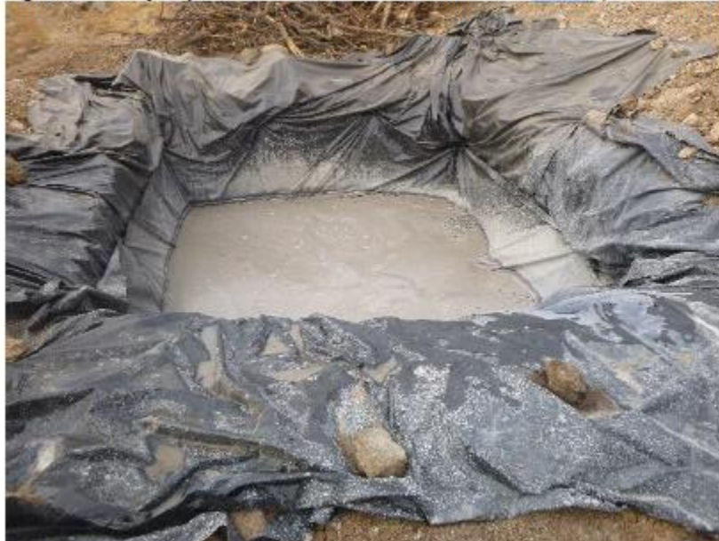
Figura 1-15. Ejemplo zona de lavado de camiones mixer (referencial).
