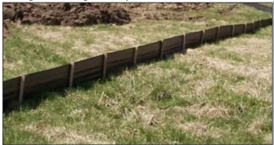
Figura 6.2.9. Fotografía de dispositivos de retención de sedimentos.
