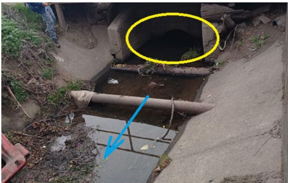
Foto 5: Alcantarilla prácticamente colapsada. Atravesio Longitudinal Sur, antigua ruta 5.
