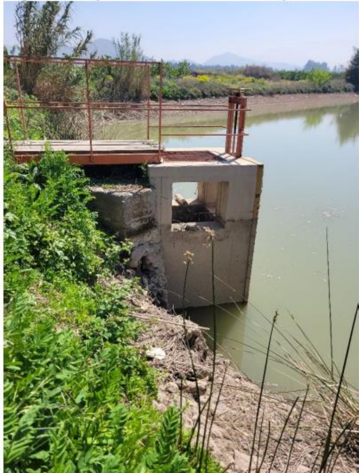
Figura 34. Compuerta de canal Estación en tranque Estación
