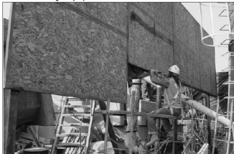
Figura. Ejemplo de Instalación de Pantallas Acústicas.
