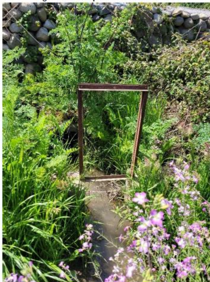
Figura 35. Compuerta de canal Tronco
