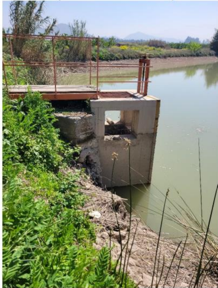
Figura 34. Compuerta de canal Estación en tranque Estación
