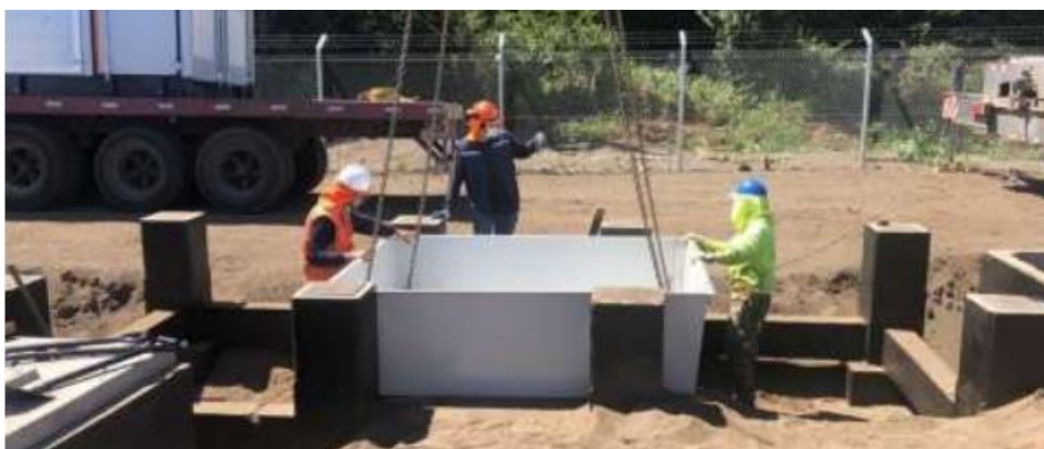
Fuente: Figura AD- 24: Cubeta de recolección de aceites del transformador, Adenda Complementaria.
