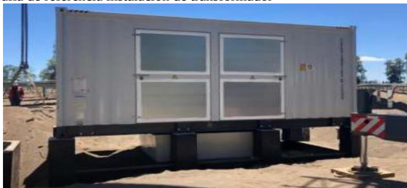
Fuente: Figura AC- 59: Fotografía de referencia instalación de transformador, Adenda Complementaria.
