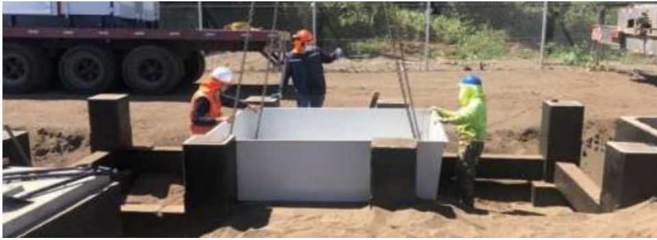
Fuente: Figura AD- 24: Cubeta de recolección de aceites del transformador, Adenda Complementaria.
