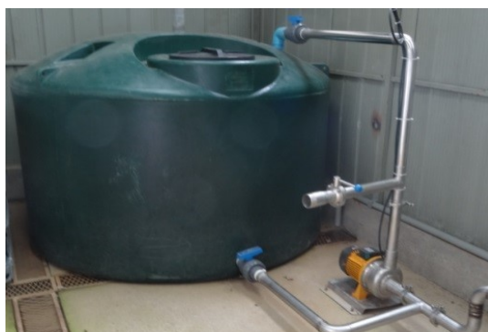
Figura. Estanque de acopio de ensilado. (Anexo Respuestas Observaciones Ciudadanas, Adenda 1)
