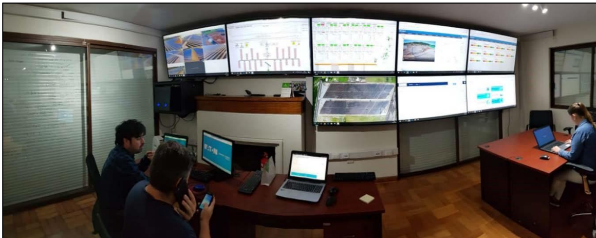
Sala de control sistema SCADA plantas fotovoltaicas de oEnergy
