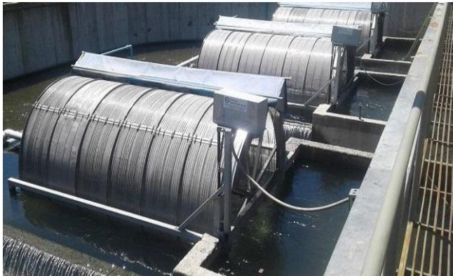
Figura N° 61. Filtros rotatorios ubicados dentro de un muro perimetral
