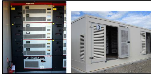
Figura 7. Estación de inversores
